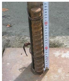
PC鋼棒の破断面は大根切れ
