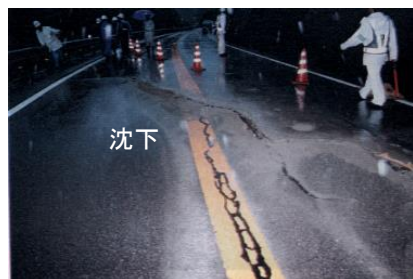
路面の亀裂と沈下
