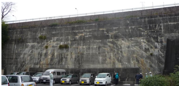
写真 12.1 扶壁式擁壁の壁面のひび割れ状況
