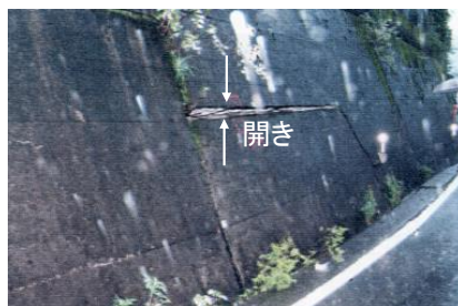
山側擁壁コンクリート打継目の開き
