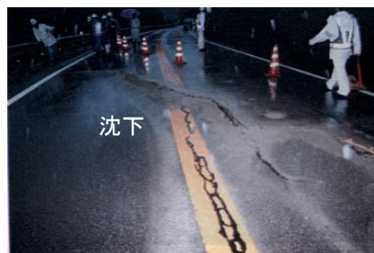
路面の亀裂と沈下
