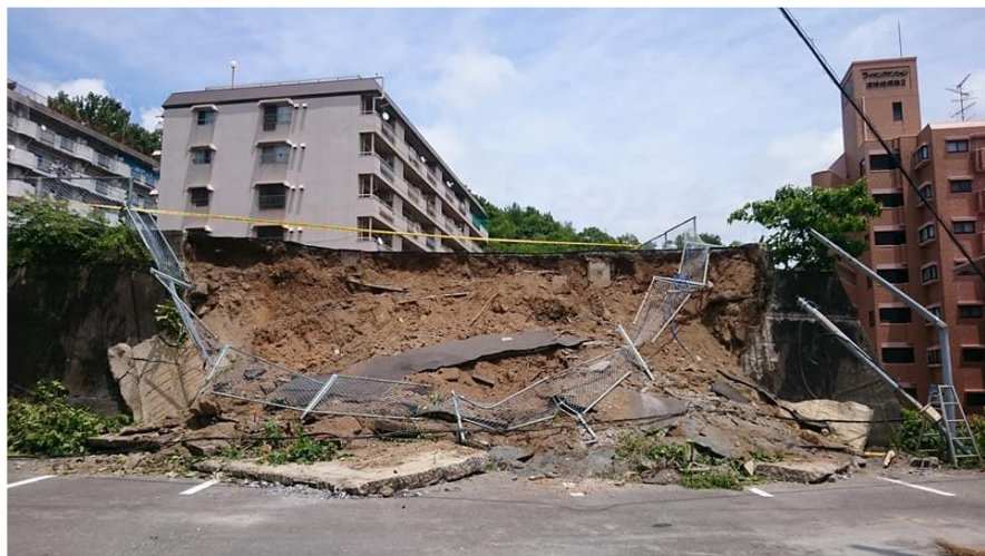
写真 3.1 倒壊したコンクリート擁壁(森伸一郎氏撮影)
