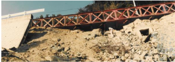
写真 4.1 倒壊したブロック積み擁壁
