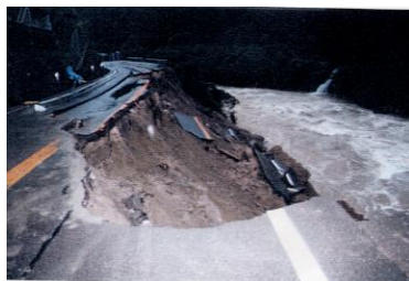
道路が路側擁壁と崩壊した直後
