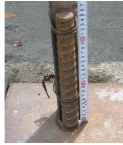
PC鋼棒の破断面は大根切れ
