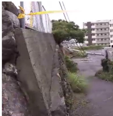
写真 3.2 倒壊した擁壁の端部
