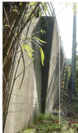
(c) 擁壁が9°前方へ傾斜
