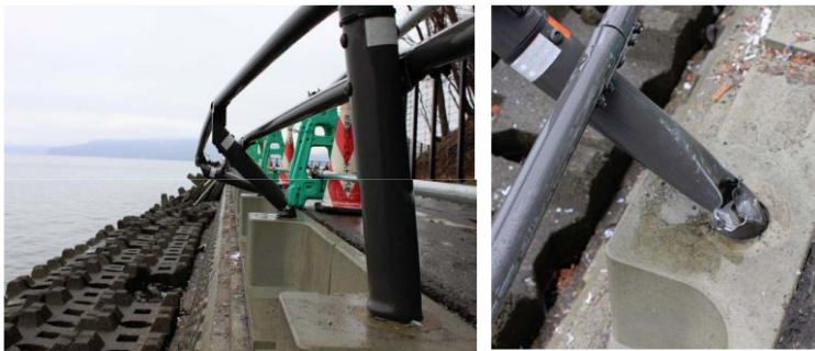
写真 23.2 北海道千歳市支笏湖のガードレールの破損事故(2010年8月)
