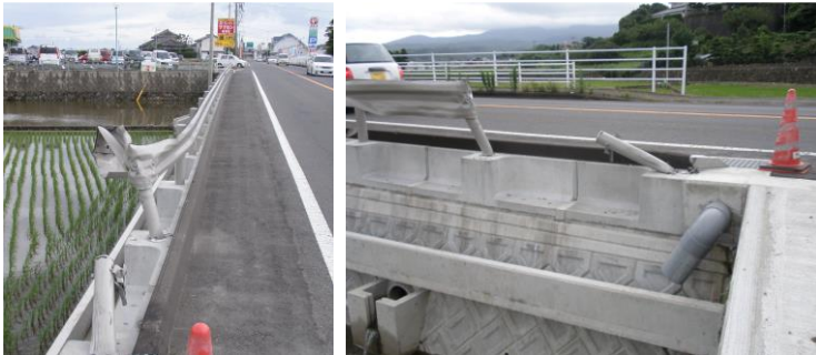
写真 23.1 長崎県雲仙市吾妻町のガードレールの破損事故(2009年8月)
