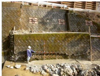
写真 17.2 護岸に水平方向の亀裂
