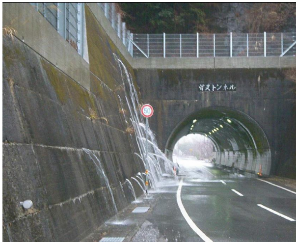
写真 16.1 山留め擁壁の水抜孔からの噴流
