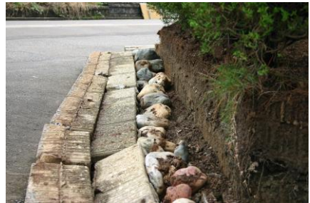
写真 15.5 長岡市高町の住宅の石垣の崩壊
