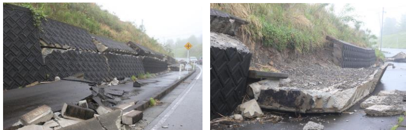
写真 15.1 西原村の県道 28 号のブロック積擁壁の損壊
