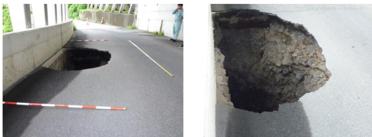
写真 19.1 道路の陥没状況
