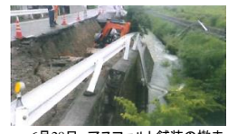
6月28日 アスファルト舗装の撤去作業中に突然擁壁が崩壊
