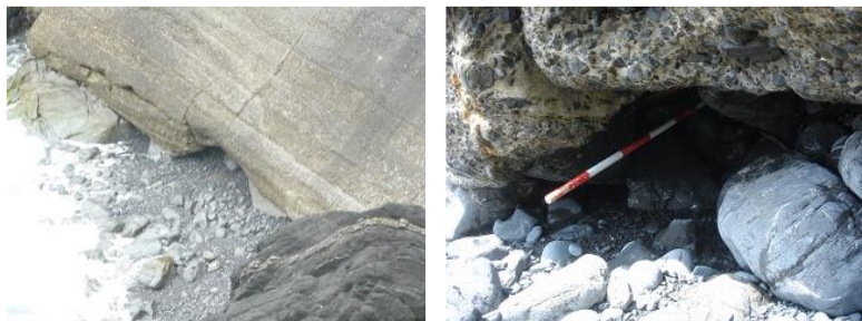
写真 19.3 路側擁壁の根元の洗掘状況
