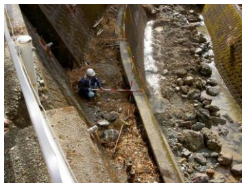
写真 17.1 護岸背後に30cmの隙間
